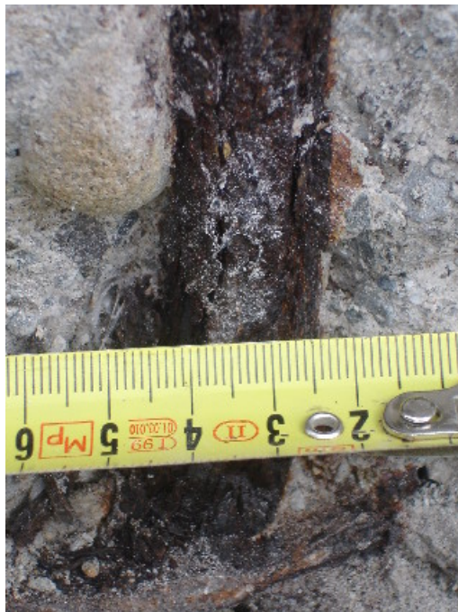
Corrosione dell'armatura esterna dei pilastri posti al piano terra
